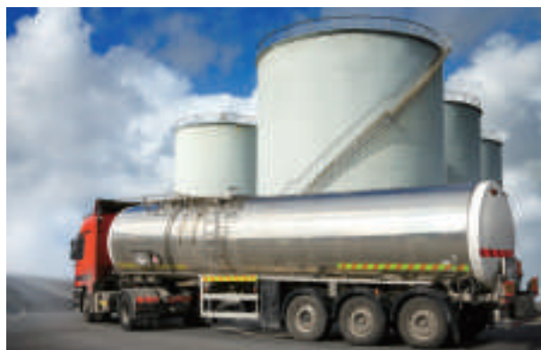
圖5-20 儲油槽和油罐車，大多為淺色
