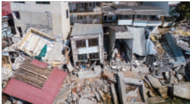
▲圖 6-14 建物設計不良無法抵擋地震而崩塌。
